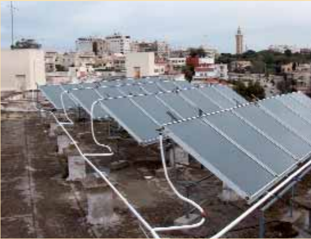
Installation collective de chauffe-eau solaires à éléments séparés - Source : CDER.
