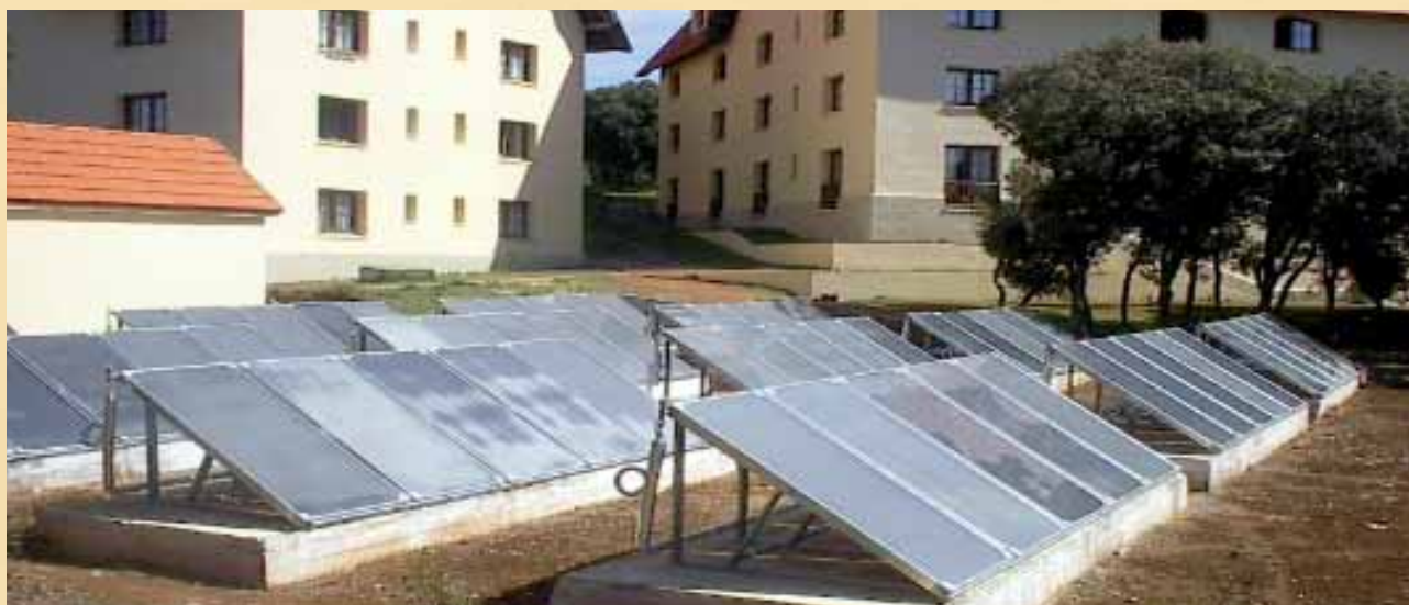
Installation de solaire thermique à l'Université Al Akhawayn à Ifrane - Source : Programme USAID.
